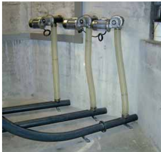
Uebergabeeinheit von Pelletlagerraum auf Kesselzufuhrschnecke
