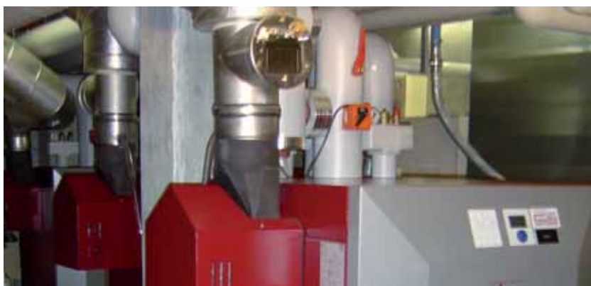
Dreikessel-Anlage mit Kaminanschluss.
