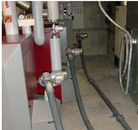
Dreikessel Anlage mit Kesselzufuhrschnecke für Pellet
